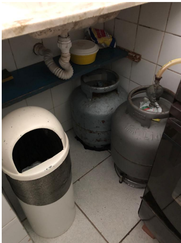
Imagem 02: Cilindros de GLP 13kg sendo utilizados no interior da edificação
