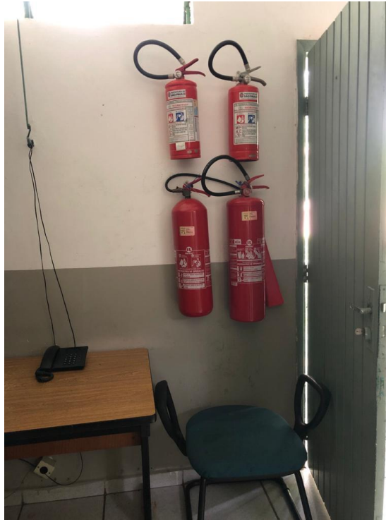
Imagem 01: Extintores vencidos e obstruídos.
